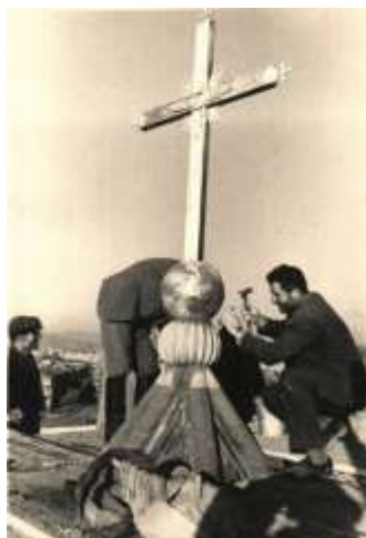
Илл. 3. Бригада Мукуча Мхитаряна во время восстановления колокольни храма Всеспасителя, 1965. Источник: URL: http://cfa.am/en/construction-masters (дата обращения: 31.03.2020).
